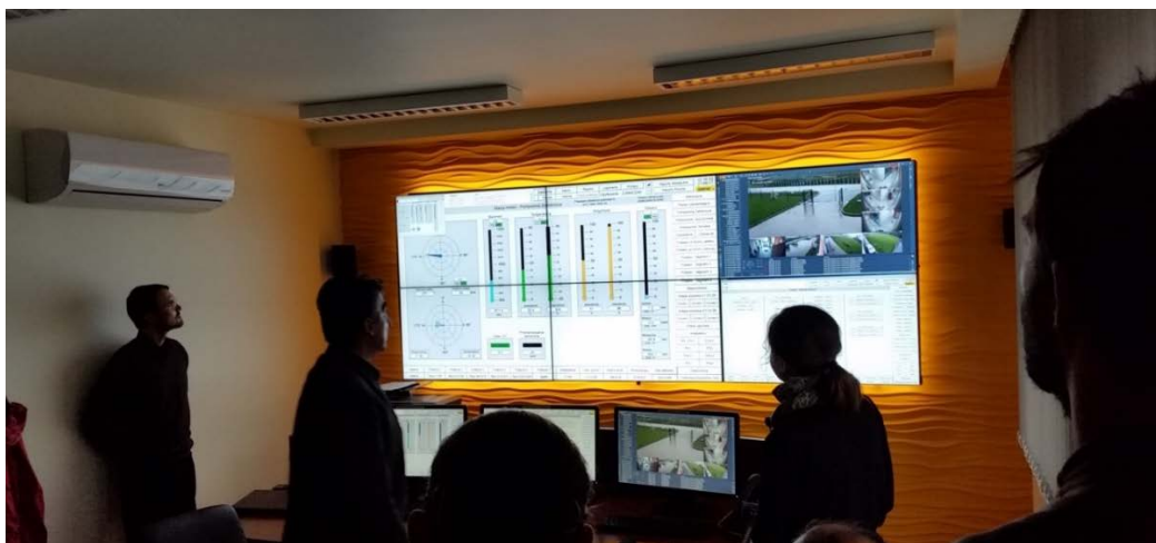
Dispečerské pracovisko vodnej stavby s online výstupmi sledovaných javov a veličín
